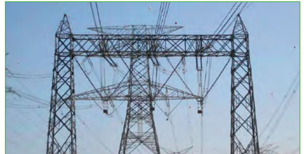
ت. برج قنطري (400/ 132 Gantry كيلوفولت)
