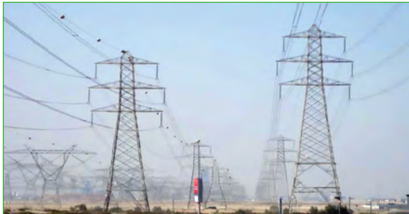
ث. برج شبكي فولاذي 132 كيلوفولت (برج مزدوج الدارة)
