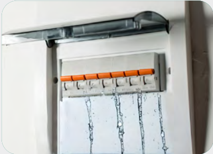
تحقق من عدم وجود أضرار ناجمة عن تسرب المياه في المآخذ والمفاتيح الكهربائية والأسلاك Check outlets, switches and cords for water damage
